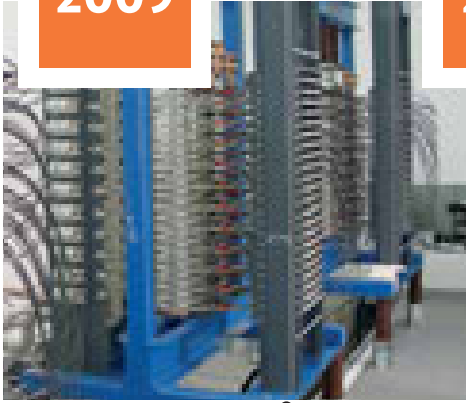
ТМК-RESITA Статический компенсатор реактивной мощности
