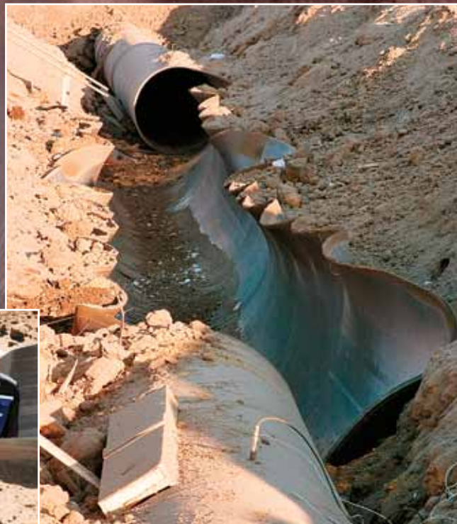
Разрушение остановлено в пределах первой трубы!
