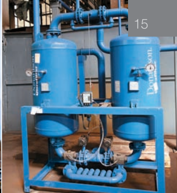
Осушитель на линии по производству прямошовных ТБД (ВТЗ)
